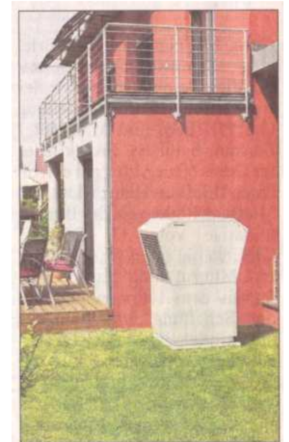
Über solche Kästen vor dem Haus wird Luft zur Wärmege- winnung angesaugt. Foto: BWP
